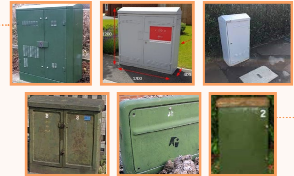
Cabinete de telecomunicații
